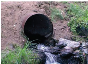
Ponceau avec approches instables
